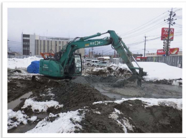
①杭工事にて掘削液等を使用するため、セメントミルク混じりの汚泥が発生します。
